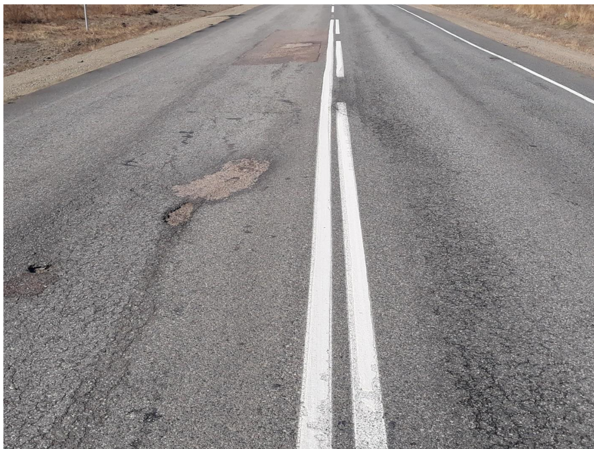
Рис. 3. Дефекты существующего покрытия
